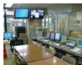
中央監視室（河川砂防課内）
